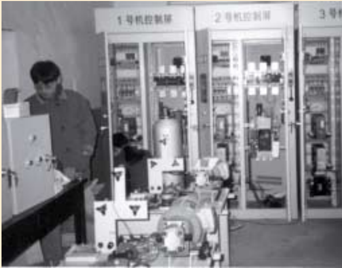
Dispositif de commande automatisé d'une petite centrale hydroélectrique en Chine. Photo : Ressources naturelles Canada.
