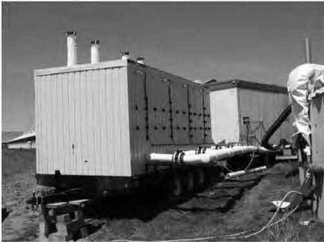
Biofiltre expérimental en opération sur une fosse à fumier couverte
