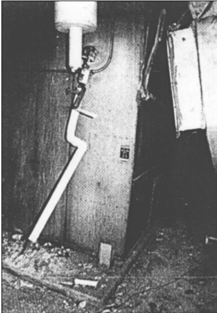
Figure 8 Défaillance des conduits d'un appareil de ventilation lors du tremblement de terre de 1994 à Northridge en Californie (McKevitt et al. , 1995)
