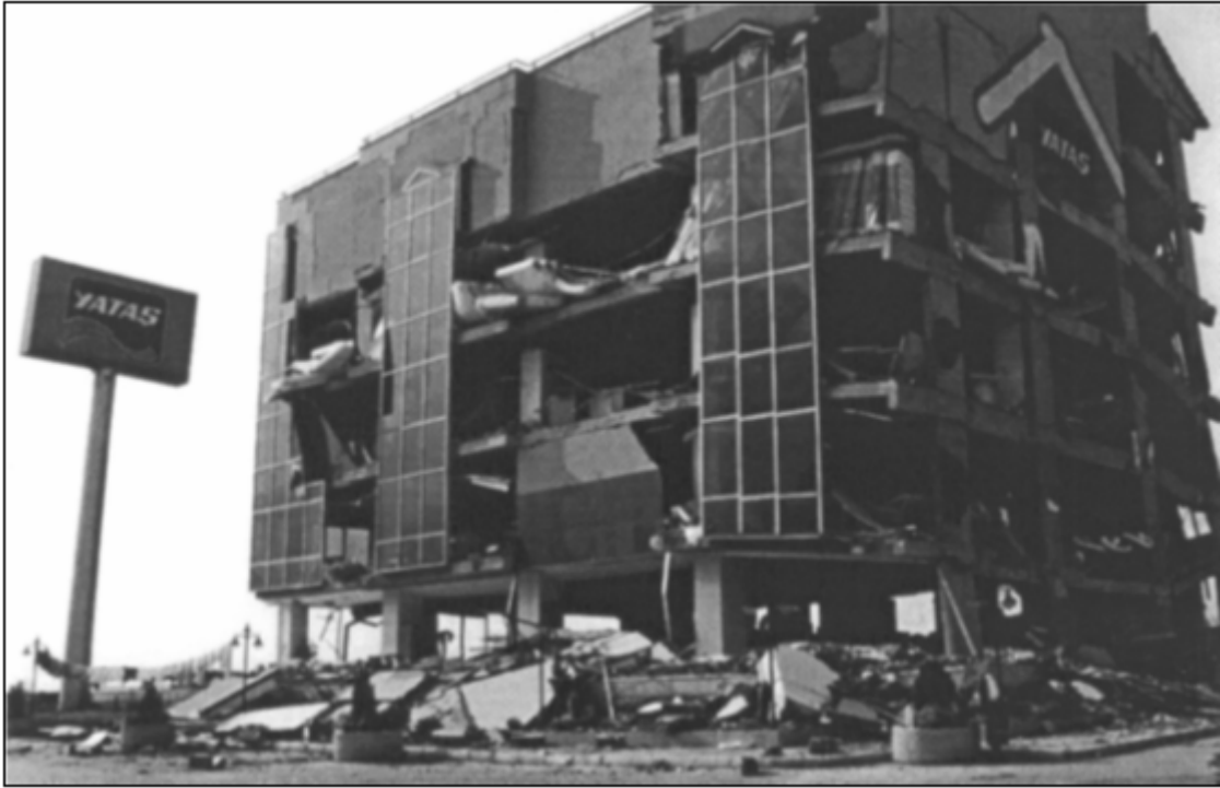
Figure 12 Exemple de dommages aux murs de maçonnerie non porteurs lors du tremblement de terre de Kocaeli en Turquie (Saatcioglu et al. , 2001)
