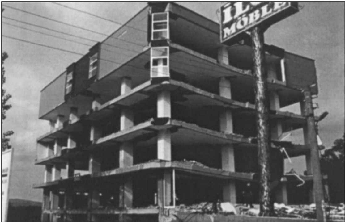
Figure 13 Un autre exemple de dommages aux murs de maçonnerie non porteurs lors du tremblement de terre de Kocaeli en Turquie (Saatcioglu et al. , 2001)
