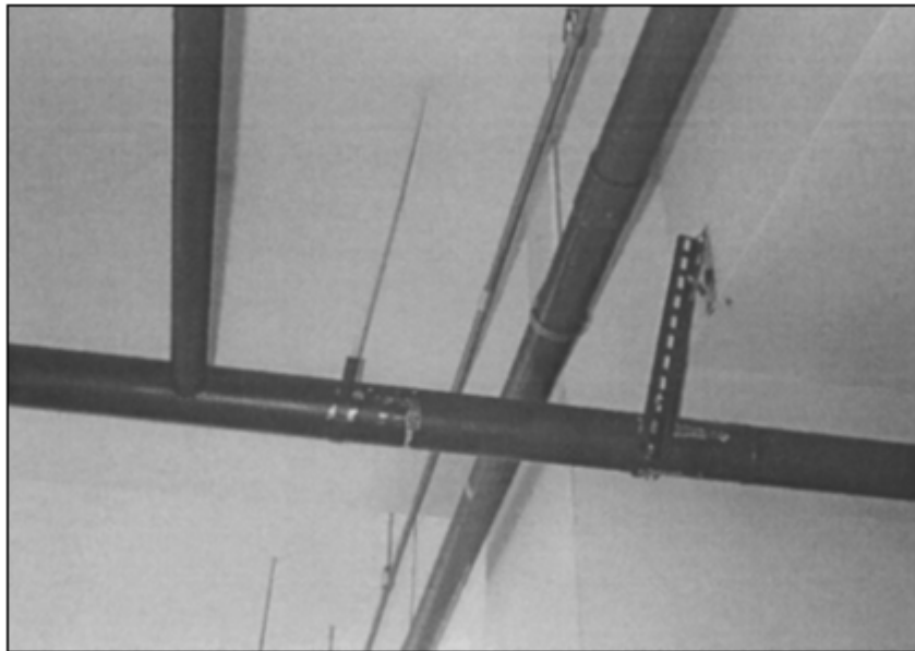
Figure 19 Dommages à un système d'extincteurs à eau du type sprinkleur lors du tremblement de terre de Jiji à Taiwan
