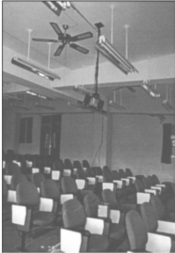
Figure 20 Danger posé par de l'équipement suspendu non retenu lors du tremblement de terre de Jiji à Taiwan.
