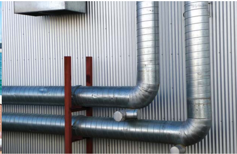
Système de chauffage centralisé à Iqaluit, Nunavut
