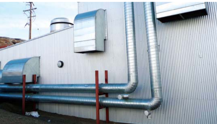
Photo du bas : Tuyaux isolés qui apportent la chaleur à un bâtiment communautaire d'Iqaluit Photo prise par : Daniel Van Vliet
