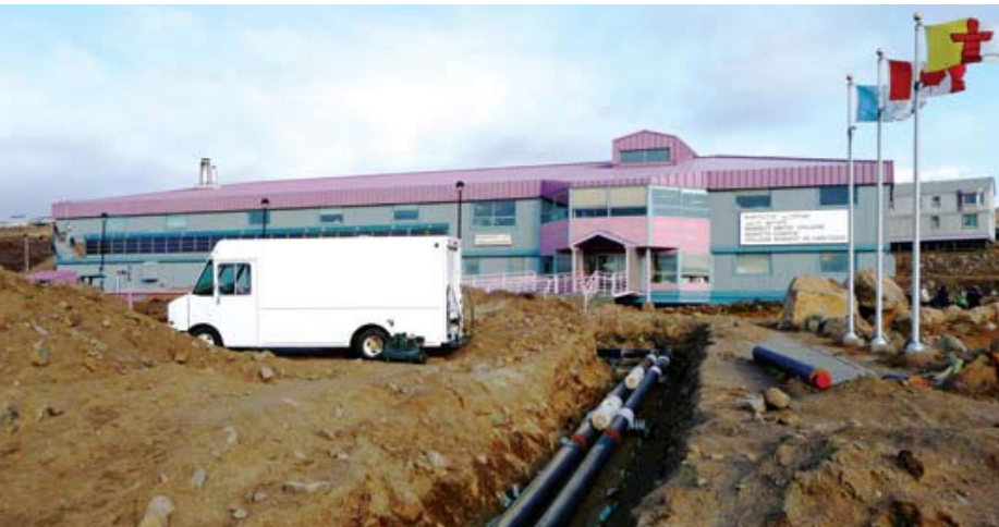
Photo du centre : Tuyaux souterrains transportant la chaleur depuis la centrale d'Iqaluit Photo prise par : Daniel Van Vliet
