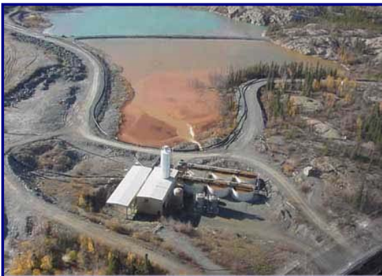
Station de traitement des eaux
