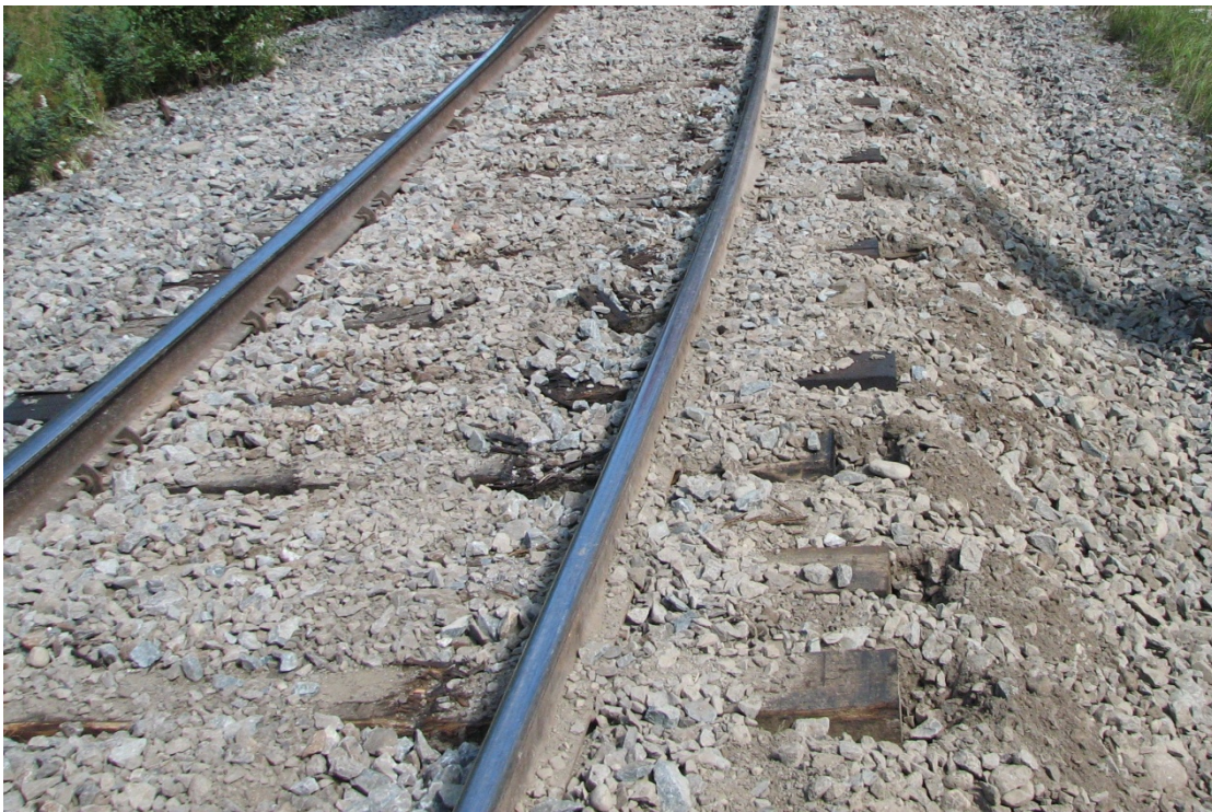
Photo 1. Ballast perturbé au bout des traverses.
