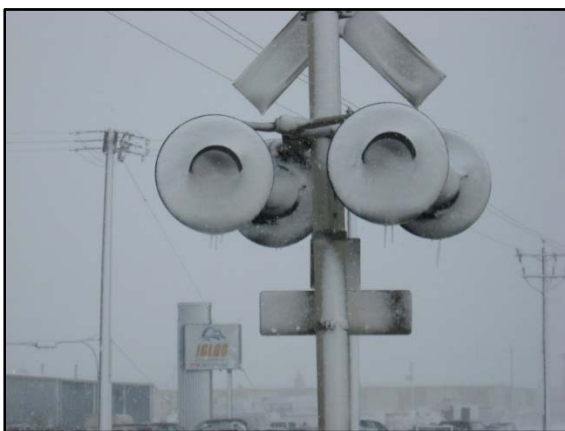
Photo 2. Signal sud, feux orientés vers le nord
