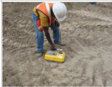
Image 10 : Jauge portative en cours d'utilisation
