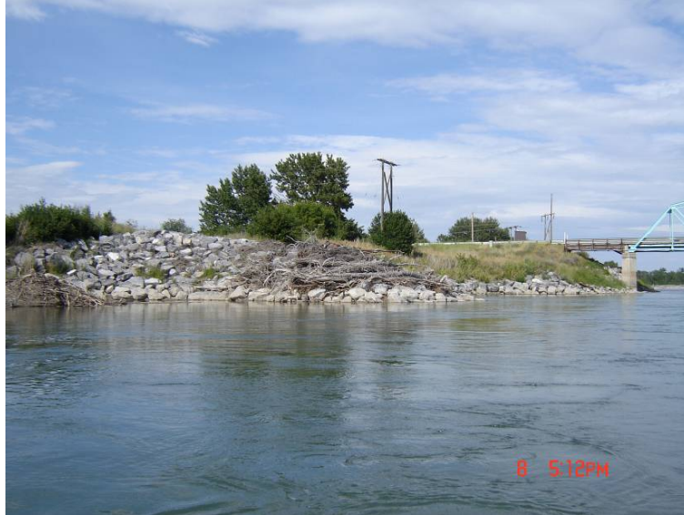
Figure 15. Rive sud de la rivière Oldman, juste à l'est du pont de la route 811 (visible sur la photographie), du côté est de la ville de Fort MacLeod (face au sud-ouest). Noter le grillage métallique servant vraisemblablement à protéger la berge de l'érosion naturelle. La superficie de sources et de zones de suintement pouvant convenir au S. bertae est si faible que ce genre de perturbation anthropique pourrait complètement détruire l'habitat. Photographie gracieusement fournie par Jennie Knopp.
