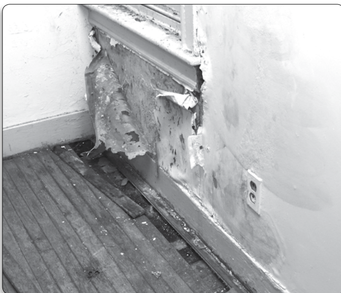
Domages provoqués par l'eau sous une fenêtre
