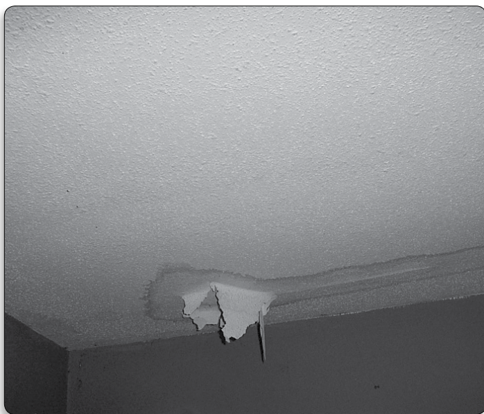
Domages causés par l'eau sur un plafond
