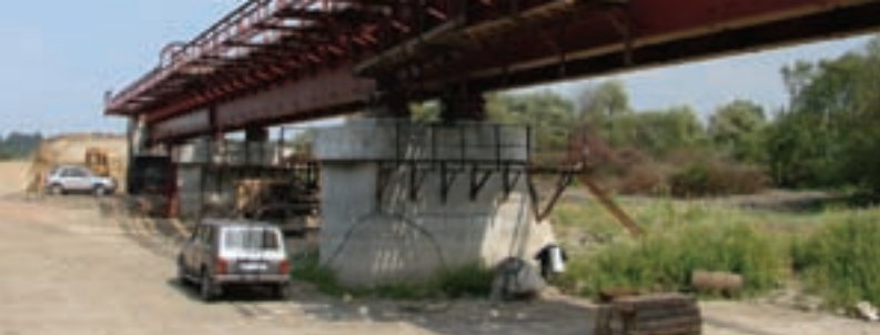
Pont ferroviaire à Shchuch'ye enjambant la rivière Miass entre l'installation de destruction d'armes chimiques et le site de stockage
