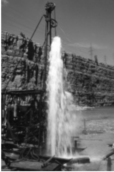
Interception d'une forte venue d'eau pendant l'exécution d'un forage dans le roc fracturé
