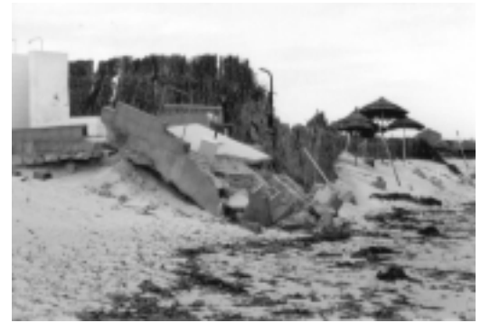
Impact de la construction d'un mur de protection qui accentue l'érosion en formant un plan réflecteur à la houle.
