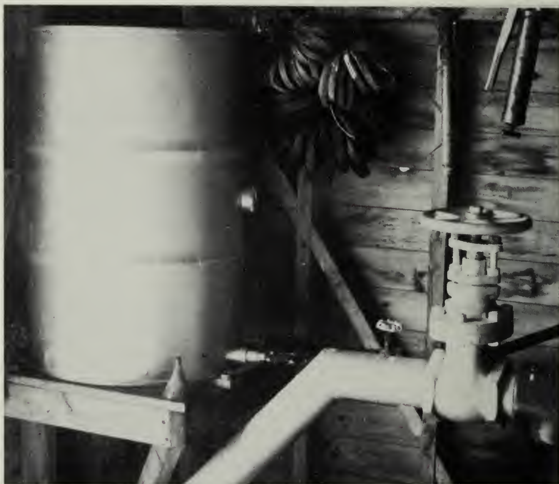
FIG. 22. L'insecticide est mélangé dans ce baril et l'épandage est effectué par le système d'irrigation.
