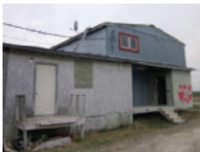
Résidence des agents de police. Lors de notre visite dans la communauté de la Première Nation Kashchewan, nous avons remarqué que les maisons des agents de police avaient besoin de réfections.
