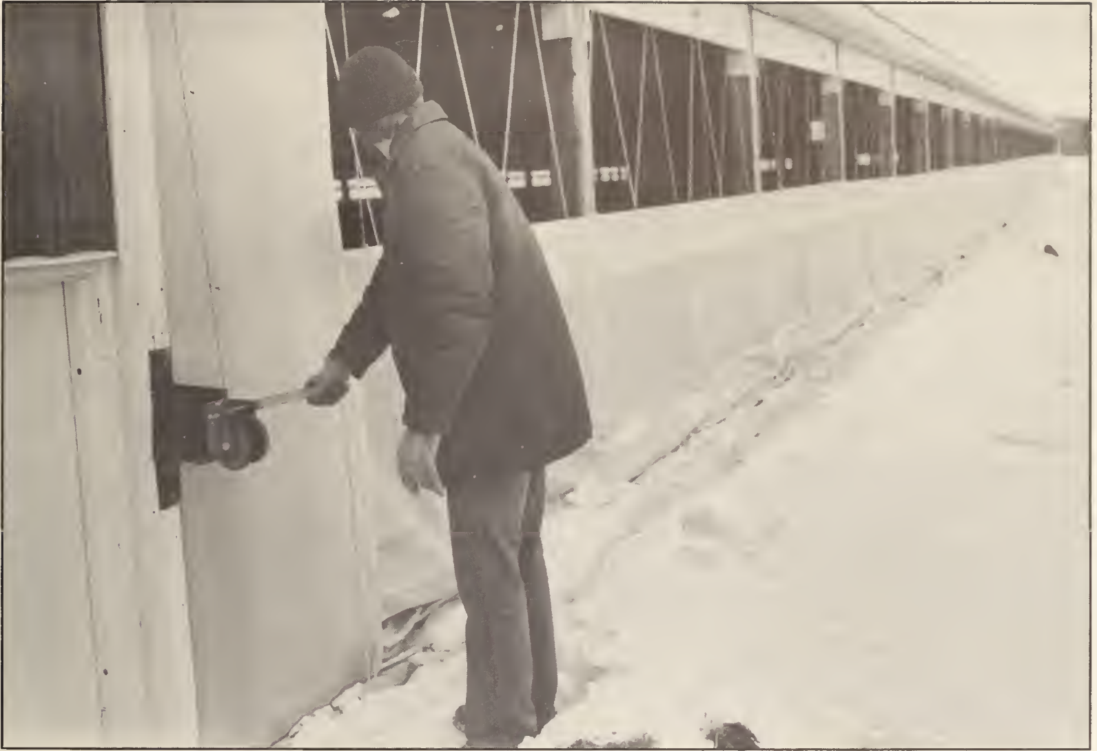
Fig. 7.17 Réglage de l'ouverture d'un écran d'aération du type "turkey curtain"
