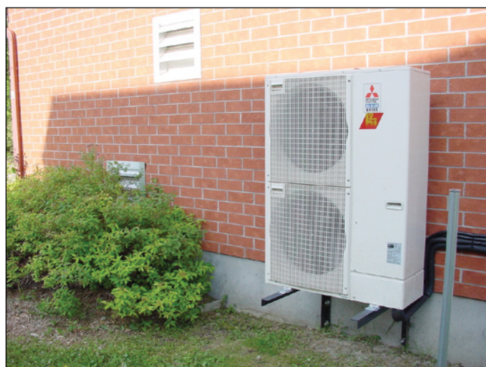
Figure 1 Partie externe de la thermopompe à air installée sur la maison d'essai du CCTR
