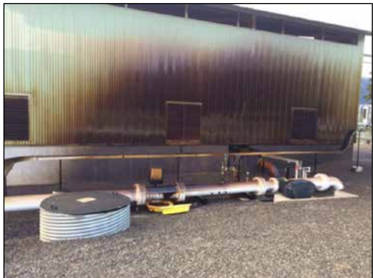
Figure 2. Pétrole projeté sur la face de bâtiment des pompes (Source : Trans Mountain)
