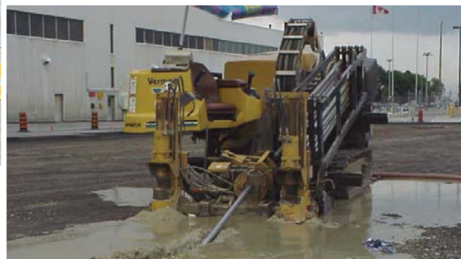
TPSGC a utilisé une machine de forage dirigé pour installer des feux encastrés sur la piste de l'aéroport, un moyen novateur d'économiser temps et argent.
