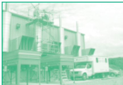
Un camion spécialement équipé du Centre de technologie environnementale d'Environnement Canada analyse les émissions d'un moteur à mouvement alternatif brûlant des gaz de décharge pour produire de l'électricité.
