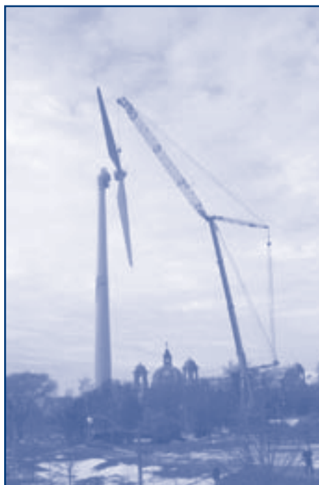
On fixe les pales sur l'éolienne de l'Exhibition Place, à Toronto. Photo : Toronto Renewable Energy Co-operative
