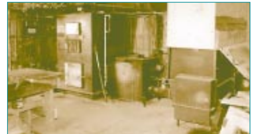
La chaudière (130 kW) chez Roger Hyatt et l'atelier à gauche.
