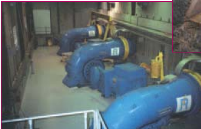
Rivière Black – conduite forcée
