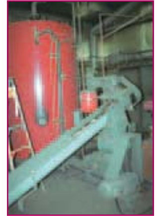
Chaudière au bois
