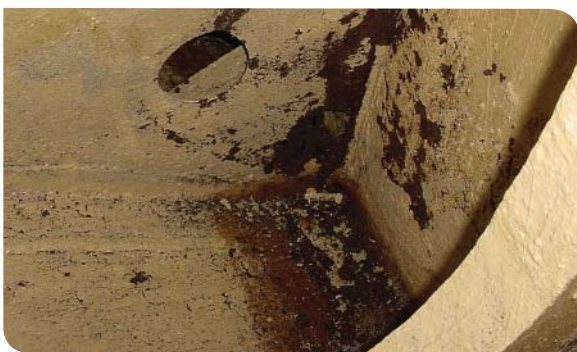
Porque perforée dans la citerne latérale supérieure
