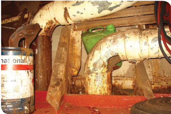
Tuyaux d'air dans le double-fond
