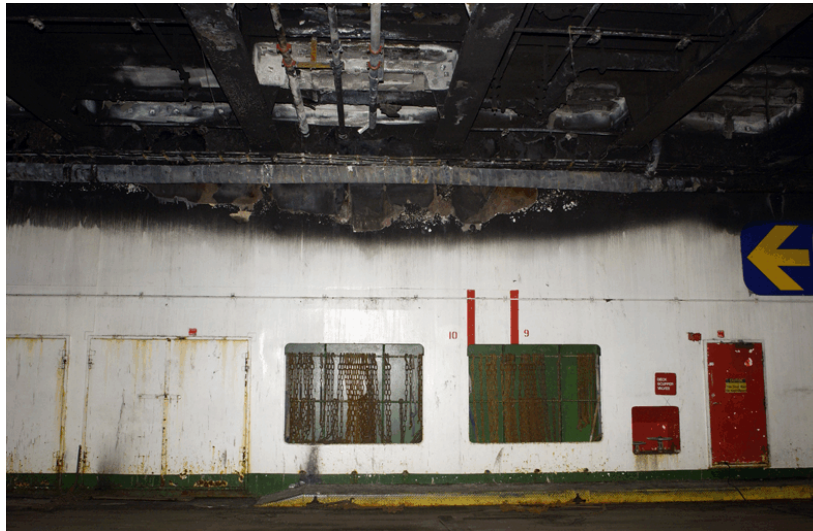
Photo 2. Avaries au plafond
