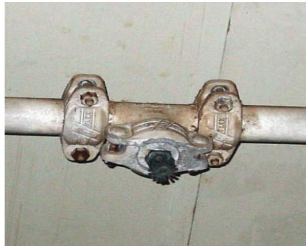
Photo 3. Tête de pulvérisation du système de rideau d'eau
