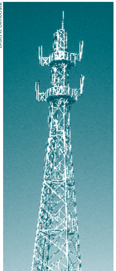
Stations de base (tours) permettant d'utiliser la technologie GSM-R.
