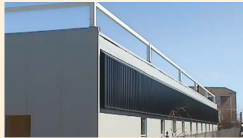
Technologie de chauffage solaire de l'air, Yellowknife, TNO, Canada.
