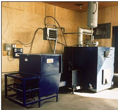
Figure 1 : Petit système commercial de chauffage à la biomasse.
