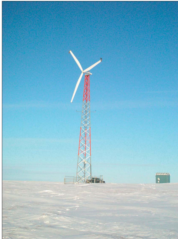
Figure 5 : Éolienne de 50 kW reliée à un réseau isolé dans l'Arctique.
