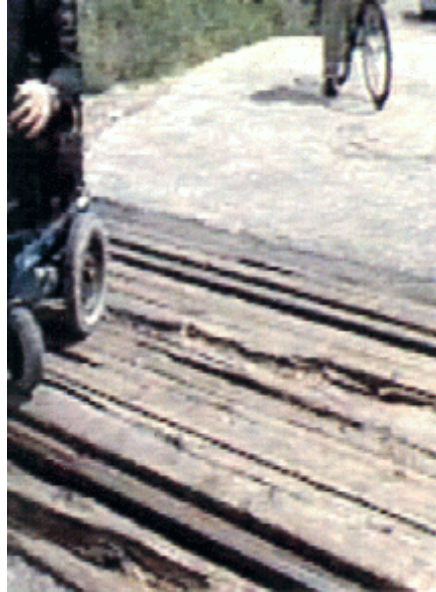
Figure 2 - Le platelage du passage à niveau était en très mauvais état.
