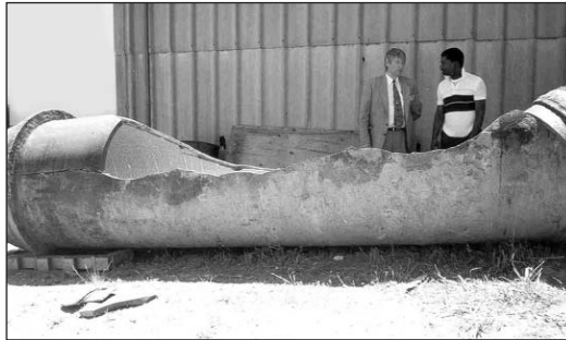
Bris d'une conduite d'eau de grand diamètre
