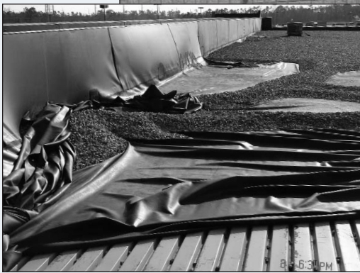
Toit ballasté complètement arraché par le vent (en haut et au milieu).
