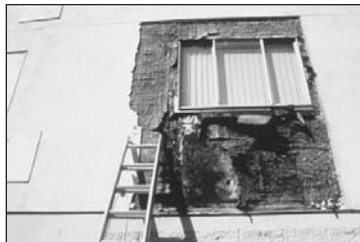
Détérioration prématurée des panneaux de revêtement et poteaux de bois adjacents à une fenêtre à bride.
