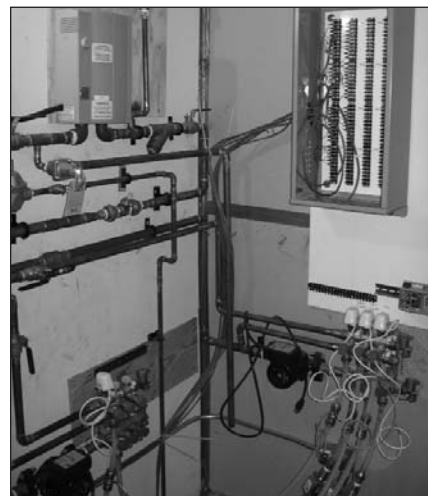
Système de chauffe-eau pour la maison de recherche sur la ventilation et les murs
