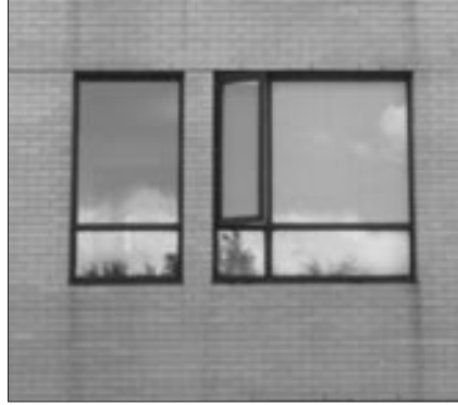
Figure 6. Taches sous les fenêtres (pas de barrières aux extrémités des appuis)
