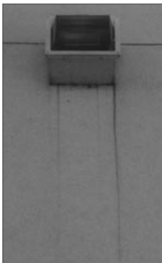
Figure 10. Taches sous un luminaire (ruissellement de l'eau)
