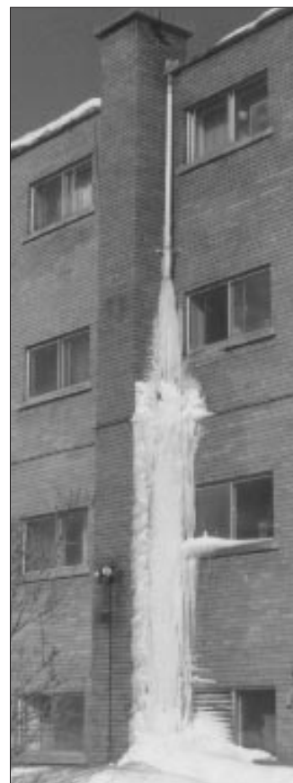
Figure 12. Accumulation de glace sous un tuyau de descente brisé
