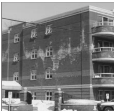
Figure 2. Efflorescences (le chaperon permet l'écoulement de l'eau sur le mur)
