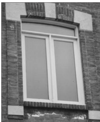
Figure 3. Efflorescences (l'eau migre à travers l'appui en brique)
