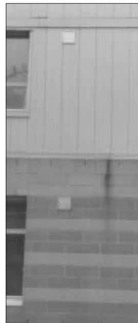
Figure 9. Taches sous une jonction du solin, en retrait par rapport au mur
