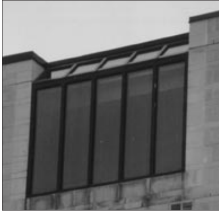
Figure 5. Taches sous un vitrage (pas d'appui débordant par rapport à la façade)
