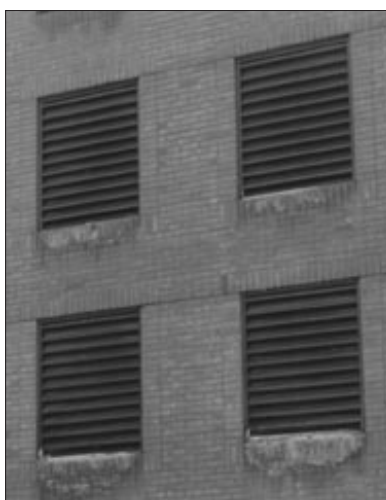
Figure 4. Taches et glace sous les orifices de ventilation d'un garage (appuis dans l'alignement du mur)
