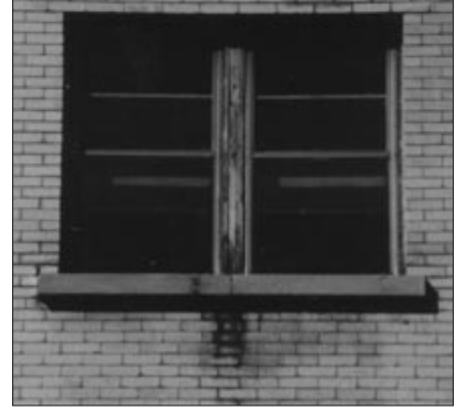
Figure 7. Taches sous une jonction d'appui de fenêtre
