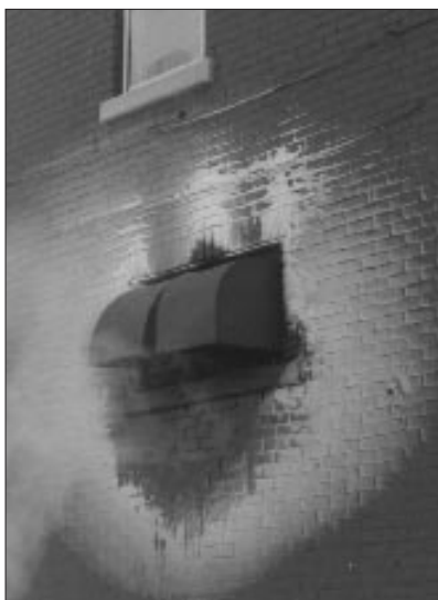
Figure 11. Gel sur le mur autour d'une sortie pour sècheuses
