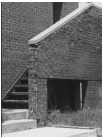
Figure 1. Dommages dus au gel (le chaperon permet l'écoulement de l'eau sur le mur)
