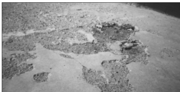
Figure 2. Détérioration d'un tablier de béton
