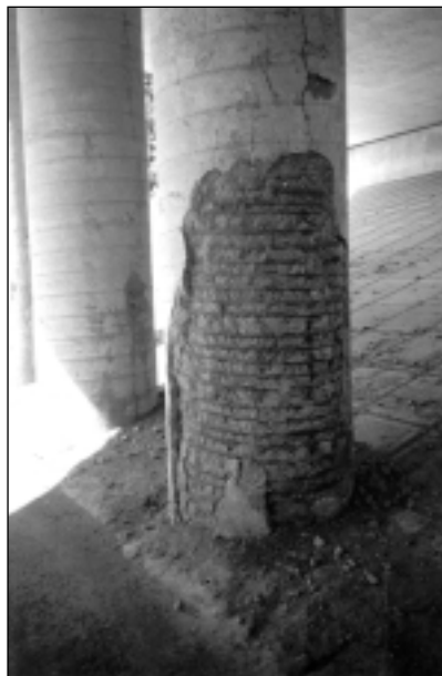
Figure 1. Détérioration d'un pilier de pont causée par des sels de déglacage projetés par la circulation
