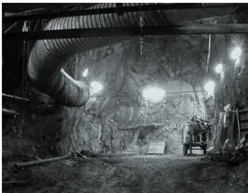
Excavation pour le nouveau laboratoire SNOLab près de Sudbury (Ontario), près de 2 km sous terre.
