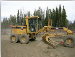
Une niveleuse à l'oeuvre dans le cadre d'un projet d'entretien routier pour la société Husky Energy
