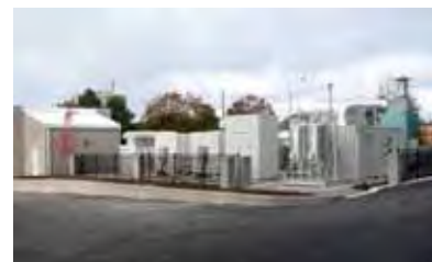
Photo : Centrale Direct Fuel Cell - Energy Recovery Generation d'Enbridge Gas Distribution et de FuelCell Energy, à Toronto, en Ontario
