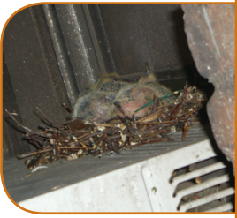
Nid de pigeon installé sur un climatiseur Photo : Rachel Lovinger
