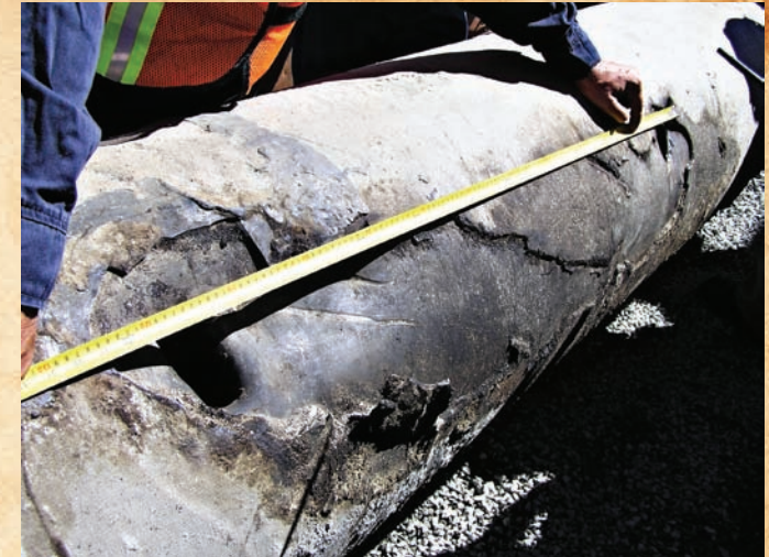
Westridge pipe rupture ❖ Rupture de la canalisation de Westridge
