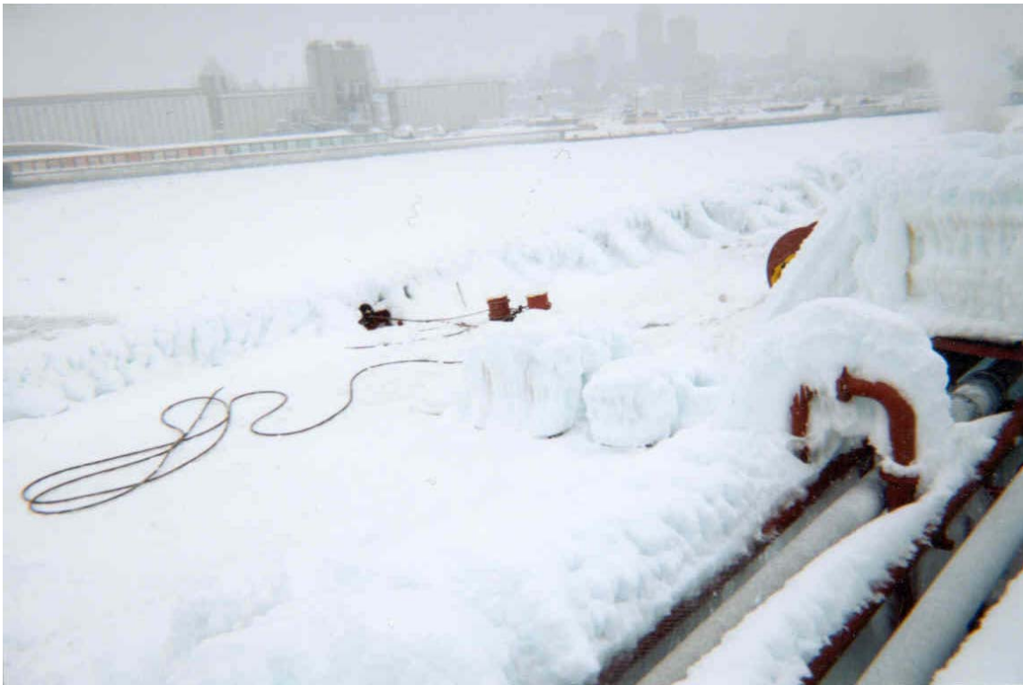
Figures 5.3F – Pont, tuyauterie et soupapes inaccessibles
