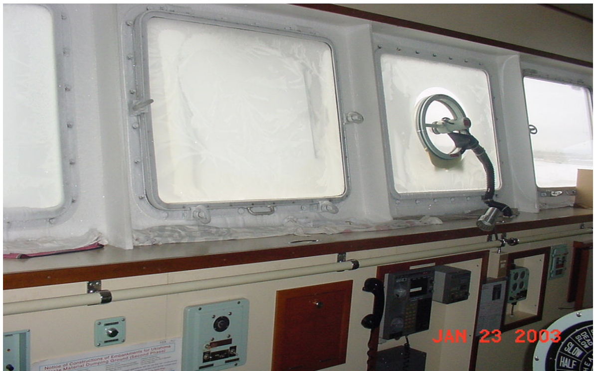
Figure 9.1B – Chauffage de la timonerie défaillant combiné à un taux d'humidité de l'air excessif
