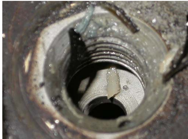
Photo 1. Fragment de produit d'étanchéité logé dans le siège du clapet
