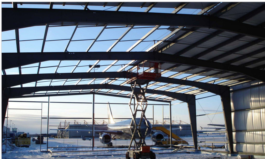
La structure en acier d'un hangar temporaire. Le projet d'une valeur de 5,5 millions $ sera complété le 18 juin 2008. Le hangar permanent, qu'on estime à une valeur de 90 millions $, en est à l'étape du design et sera complété au début de 2010.
