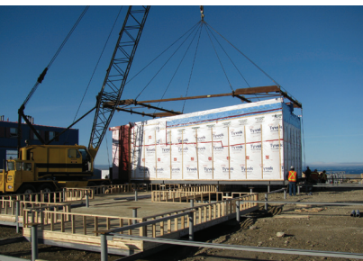
Préparation à l'installation du PPCP en vue de l'installation des modules (Resolute, au Nunavut).
