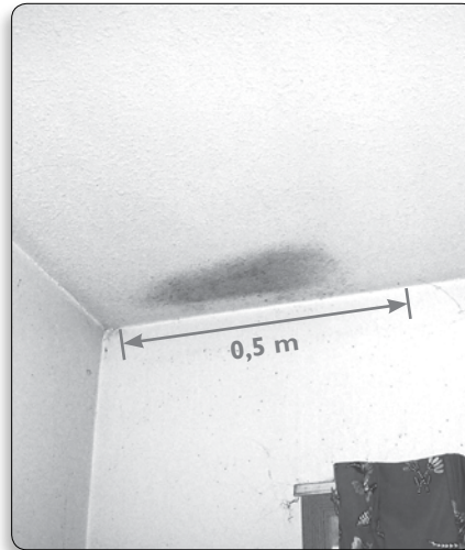
Petite surface de moisissure
