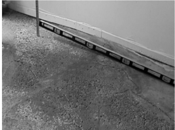
Figure 10. Soulèvement de la dalle
