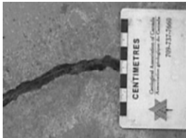
Figure 8. Ouverture d'une fissure
