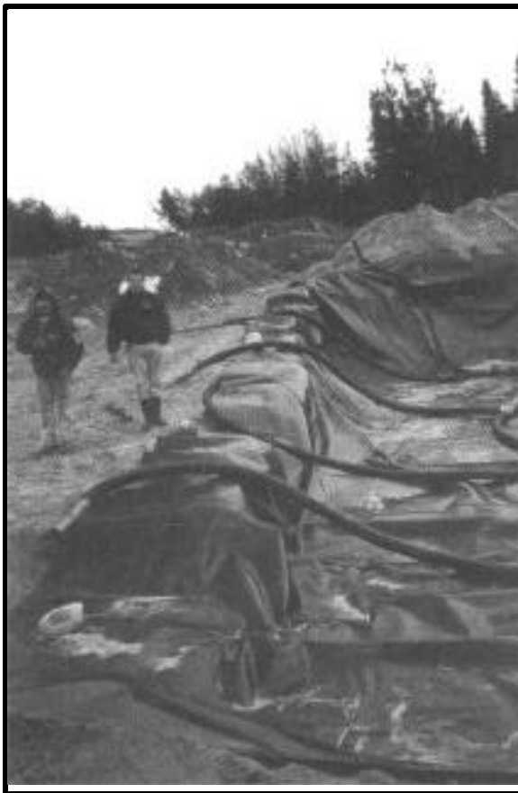
Mise en place, en 1998, d'une plate-forme pour la biorestoration de sols contaminés à Waswanipi.
