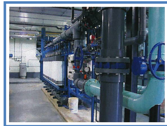
Ci-dessus : La station de traitement d'eau de La Ronge
