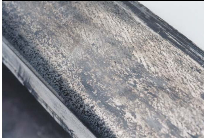
Photo 5. Fissures du champignon dans un bout de rail plus gros qu'on a récupéré
