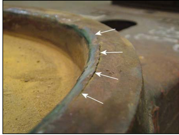
Photo 6. Rebord de la crapaudine montrant une lèvre en relief qui a été marquée par l'usure de contact
