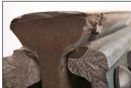
Photo 3. Fissure de fatigue à l'angle supérieur du côté intérieur de l'éclisse
