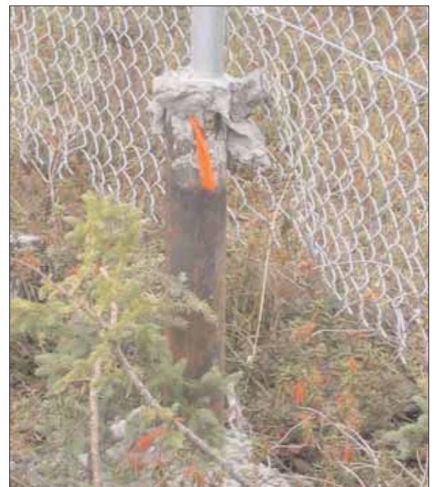
Poteaux de clôture soulevés par le pergélisol.
