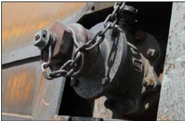
Photo 25. Robinet de déchargement par le bas
